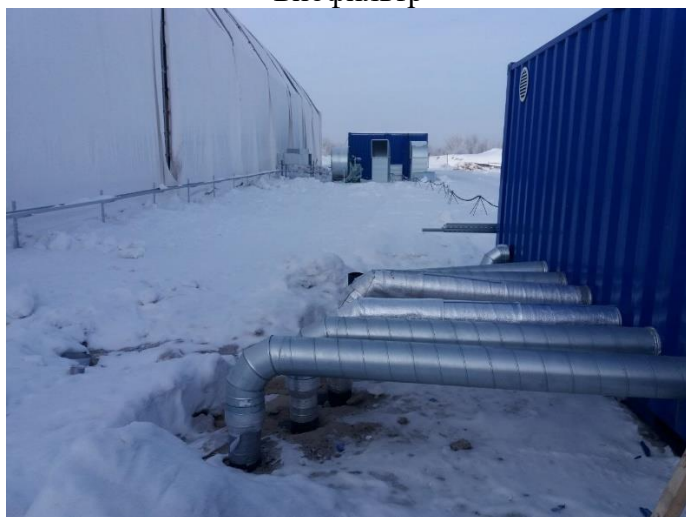
Узел подачи воздуха на аэрацию
